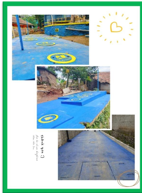
Gambar 3.3 Pembangunan Sistem Pengelolaan Air Limbah Domestik Setempat (SPALDS) Septik Tank Individu di Kecamatan Banjaran
